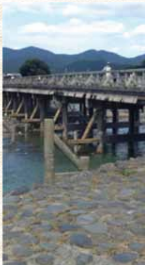
破損した渡月橋
